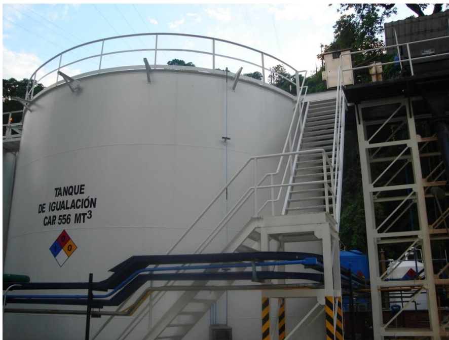
Figura 4. Tanque de igualación
