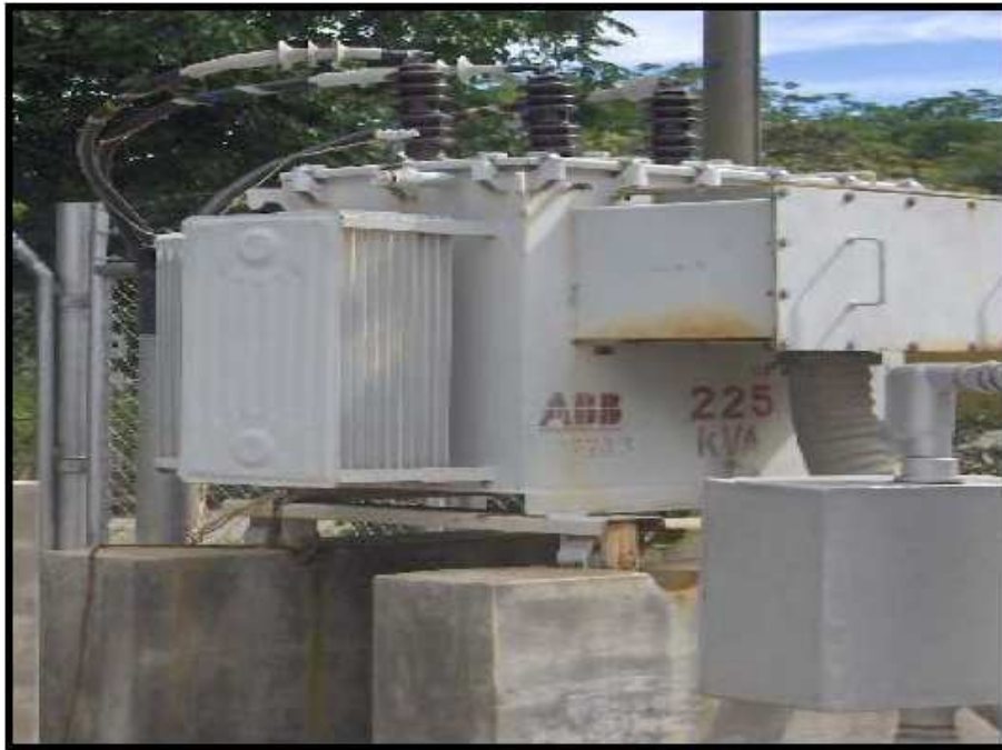
Figura 51. Transformador 225 KVA, 13200/460 VAC PIA 2.
