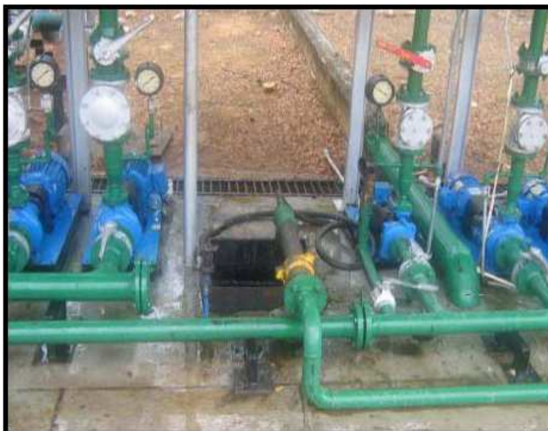
Figura 26. Transferencia de crudo PIA – Batería Monal.
