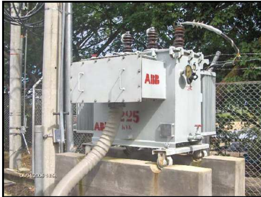
Figura 50. Transformador 225 KVA, 13200/460 VAC PIA 1
