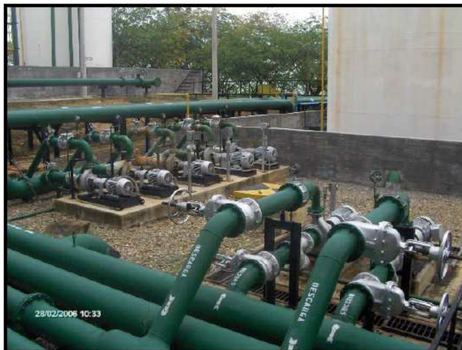
Figura 32. Bombas de Filtración.
