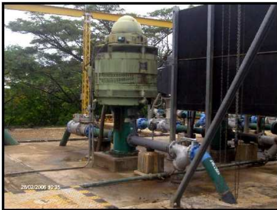
Figura 46. Bombas de inyección.
