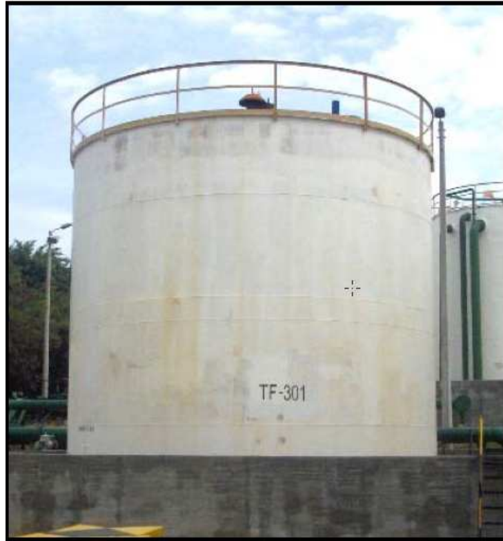
Figura 28. Tanque de Filtros.
