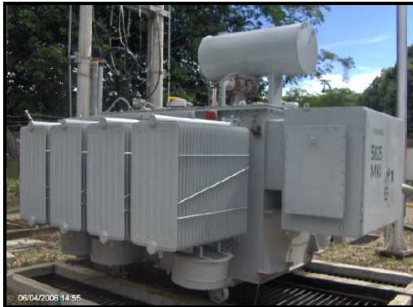
Figura 49. Transformador de 5-6.25 MVA PIA 2.
