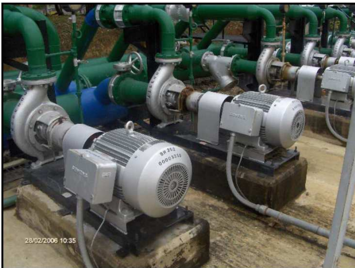
Figura 38. Bombas de retrolavado BR-301 y BR-302. filtros F1 al F8.
