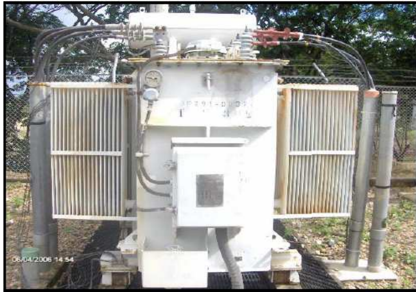
Figura 48. Transformador de 2500 KVA PIA 1.
