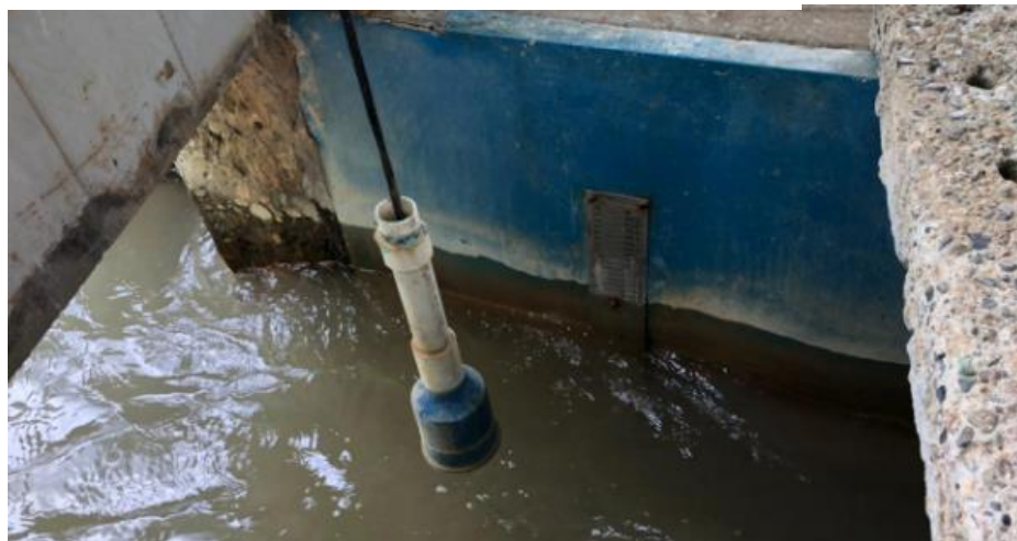
Fotografía 7. Regleta de medición de caudal
