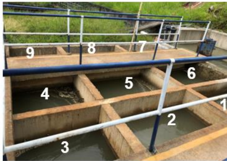
Fotografía 1. Cámaras de una sección del floculador
