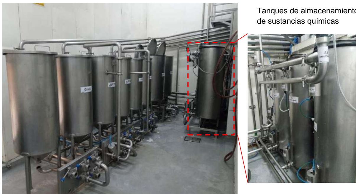
Figura 1. Tanques de almacenamiento de mezcla y de sustancias químicas de limpieza.
