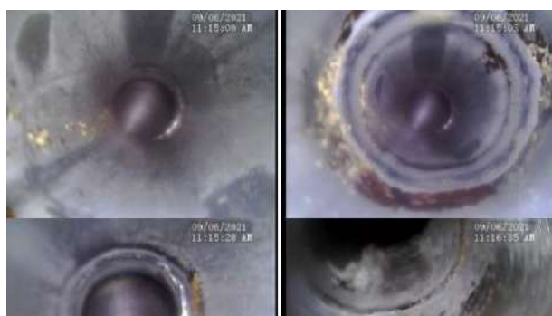
Figura 2. Interior tubería de transporte línea VTRO
