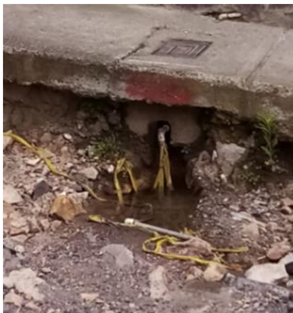
Figura 12. Visita daño en tubería externa de vivienda
