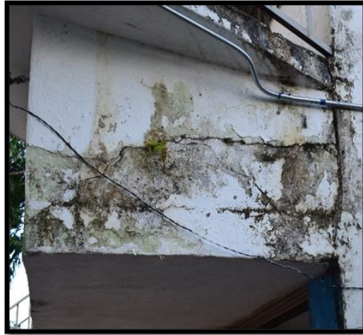
Figura 14. Evidencia de uno de los daños encontrados en el Colegio estudiado
