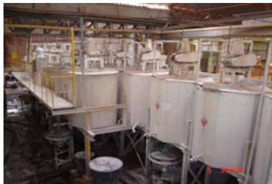
Figura 7. Balsas de almacenamiento
