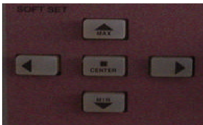
Ilustración 11. Panel de control de posición
