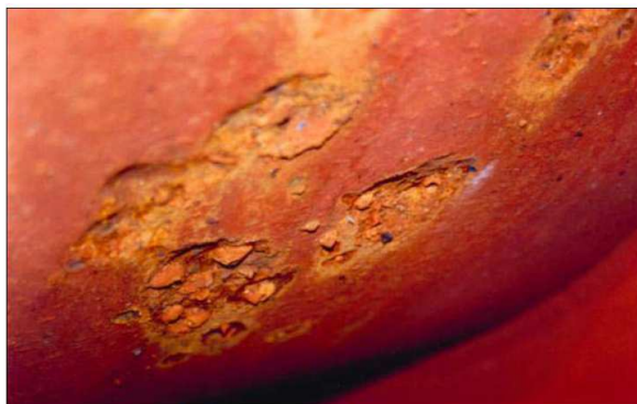
Figura 3. Corrosión en tuberías de calderas
