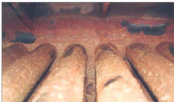
Figura 2 Incrustaciones en tuberías.
