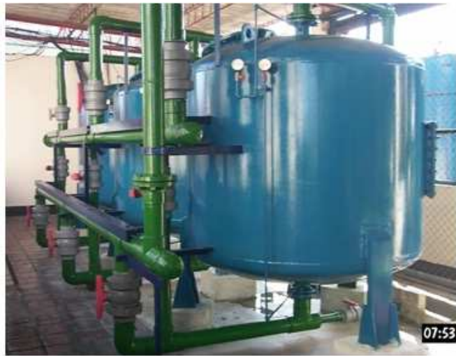
Figura 7 Sistema de filtración.
