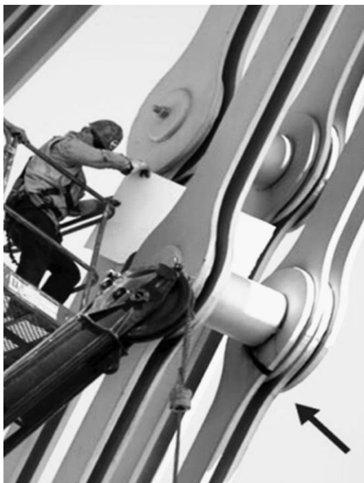
Figura 11. Puente de San Francisco Oakland Bay, monitoreo acústico de grietas. Adaptado de Poursaee (2014).
