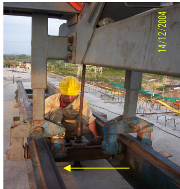
Figura 3.5 Rieles que soportan la estructura del carro de avance
