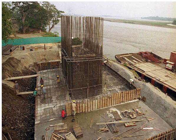
Figura 2.5 Zapata y columna del apoyo seis en la construcción del puente Barranca-Yondo
