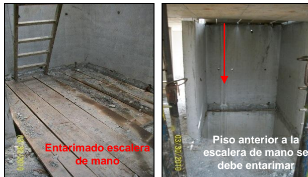
Figura Nº 7 Entarimado escalera de mano
