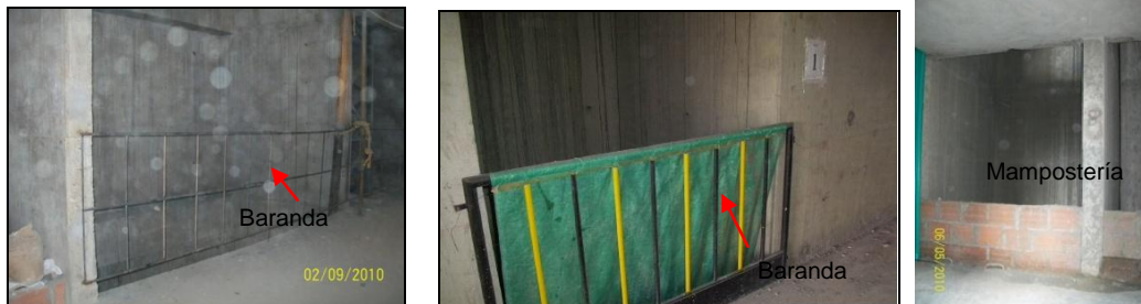
Figura Nº 6 Foso Ascensor con protección
