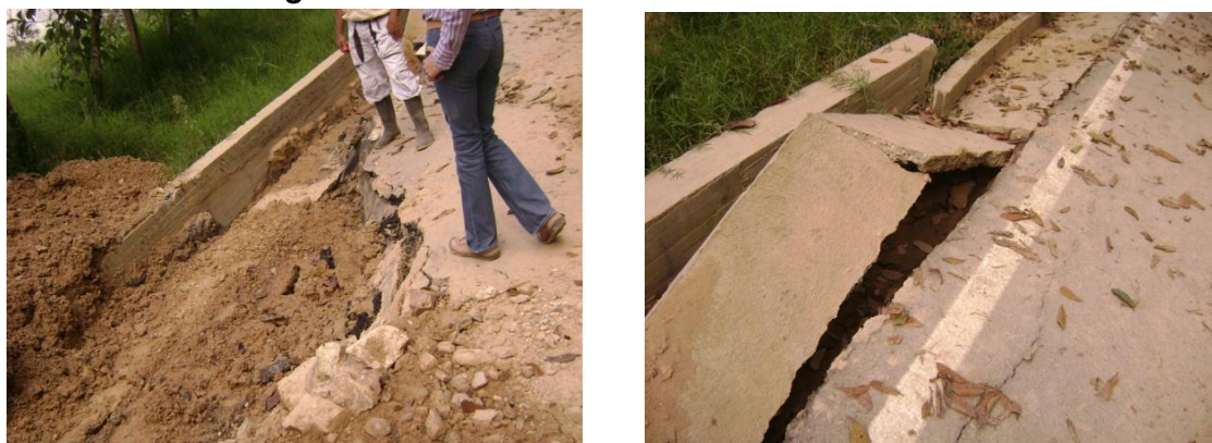
Figura 2. Visita de obra - Estado de la Vía Tona
