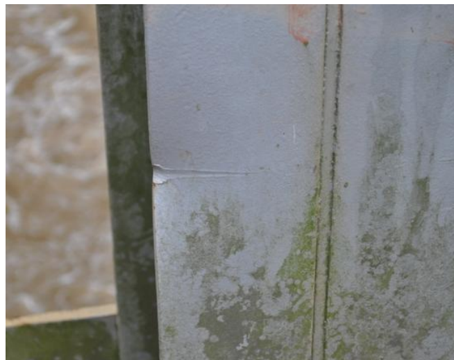
Figura 86. Abolladura por impacto en elemento vertical de la cercha. Fuente (Autores).Enero 2013
