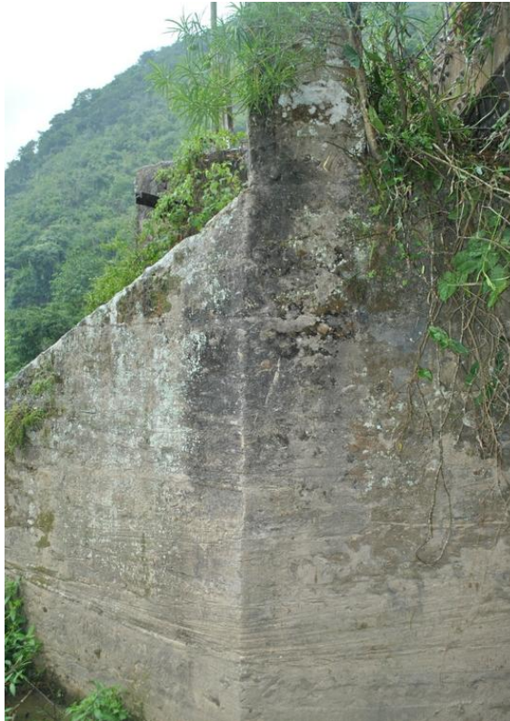
Figura 17. No hay grieta entre pantalla y aleta. Fuente (Autores).Enero 2013
