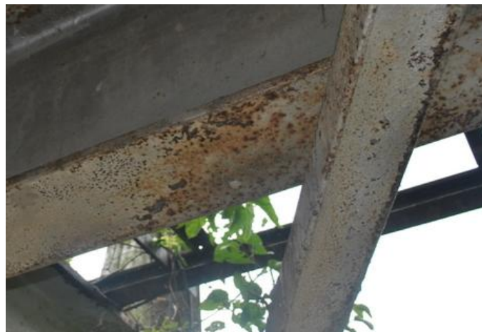
Figura 26. Estado de corrosión elementos. Fuente (Autores).Enero 2013
