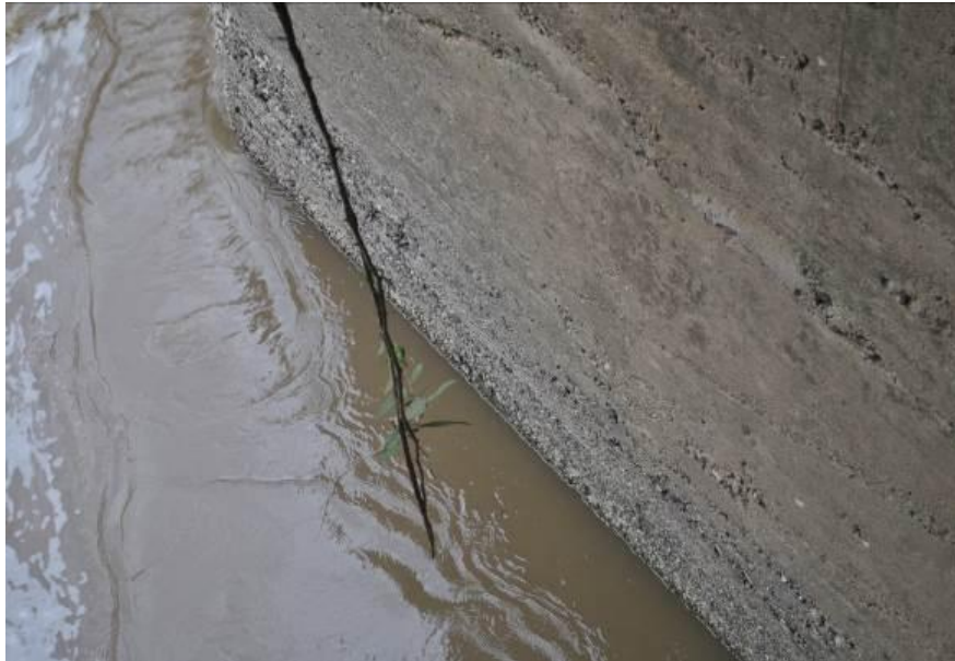
Figura 70. Socavación local en la parte inferior del estribo. Fuente (Autores).Enero 2013
