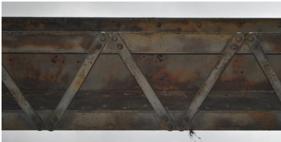
Figura 84. Corrosión media cordón superior puente 2. Fuente (Autores).Enero 2013
