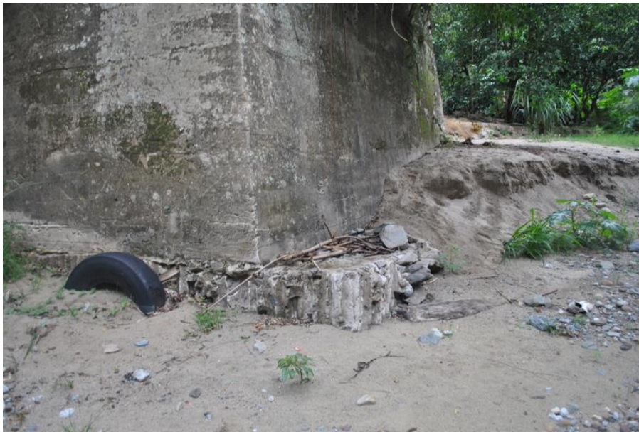
Figura 67. Socavación general en el estribo costado oriental. Fuente (Autores). Enero 2013
