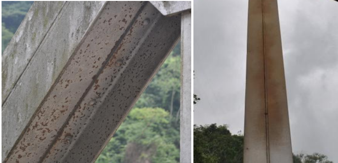
Figura 82. Corrosión leve elementos cercha puente 2. Fuente (Autores).Enero 2013
