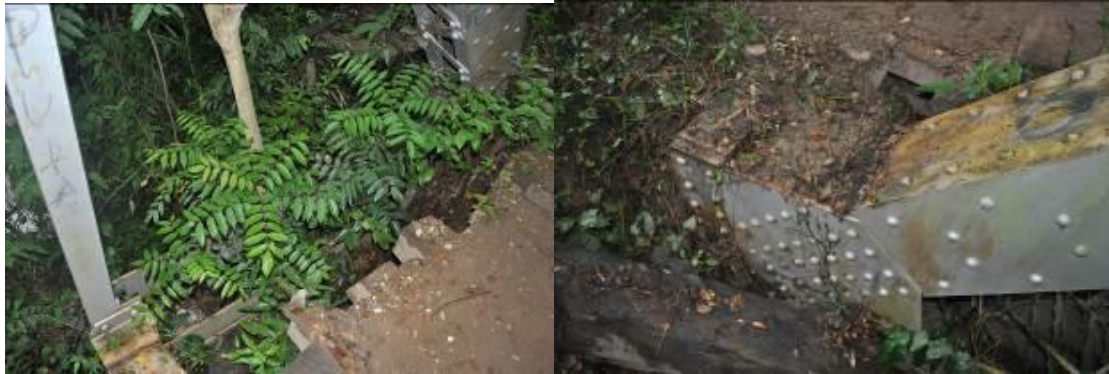
Figura 43. Apoyo izquierdo costado occidental. Fuente (Autores).Enero 2013
