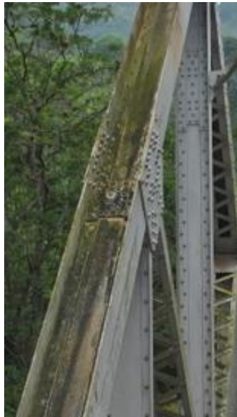
Figura 85. Elemento con pintura deteriorada. Fuente (Autores).Enero 2013
