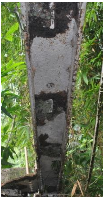
Figura 28. Remache con alto nivel de corrosión. Sección con alto nivel de corrosión. Gran pérdida de sección, Corrosión severa cordón inferior cercha.
