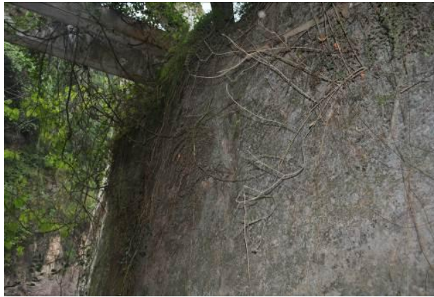
Figura 63. Contaminación estribo oriental puente 2. Fuente (Autores).Enero 2013
