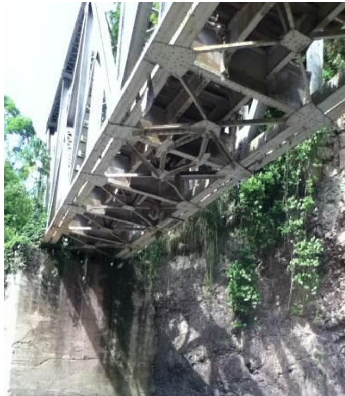
Figura 59. Contaminación estribo Puente 2. Fuente (Autores).Enero 2013
