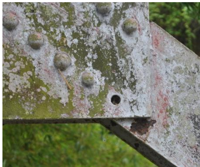
Figura 24. Remache faltante. Fuente (Autores). Enero 2013
