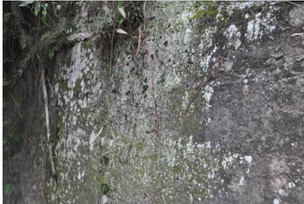
Figura 62. Posible carbonatación del concreto. Fuente (Autores).Enero 2013
