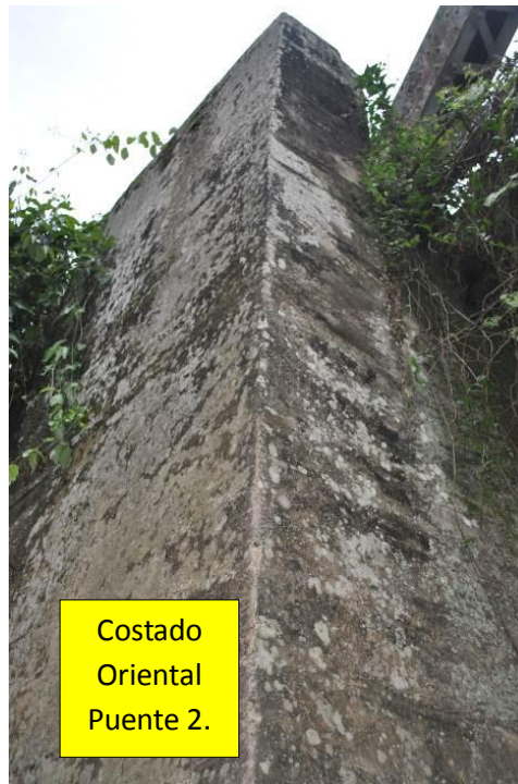
Figura 65. No hay grieta entre el muro de retorno y la pantalla. Fuente (Autores).Enero 2013
