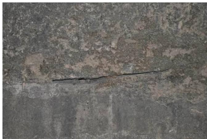
Figura 64. Grieta de gran espesor. Fuente (Autores).Enero 2013
