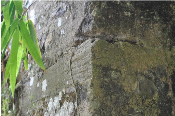
Figura 19. Grieta estribo. Fuente (Autores).Enero 2013
