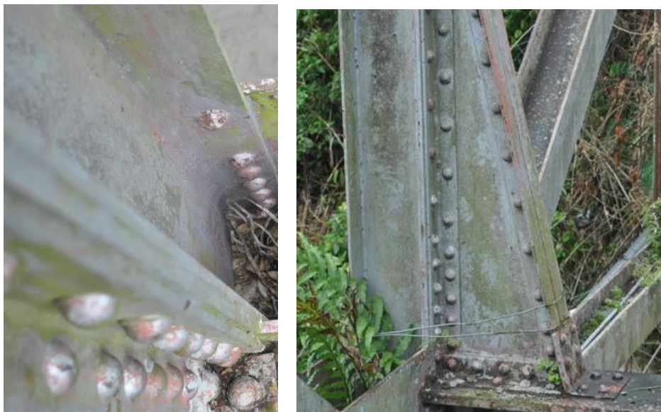
Figura 25. Elementos sin corrosión aunque con pintura deteriorada. Fuente (Autores).Enero 2013
