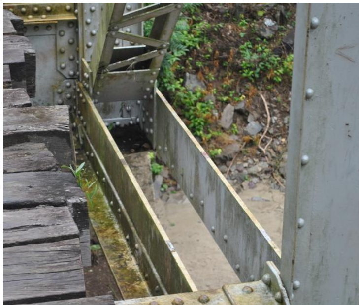
Figura 77. Perfil del cordón inferior de la armadura en la parte cercana a los apoyos del puente. Fuente (Autores).Enero 2013
