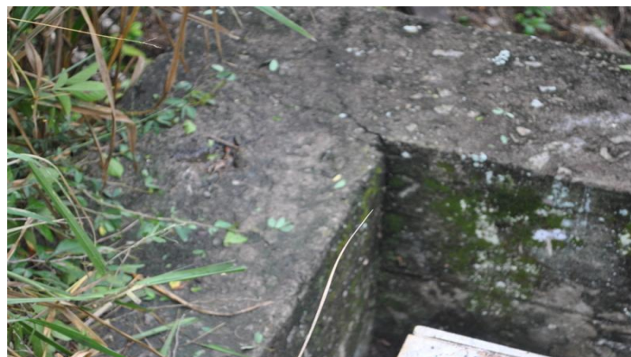
Figura 66. Fisura entre pantalla y muro de retorno izquierdo en el estribo costado oriental. Fuente (Autores).Enero 2013
