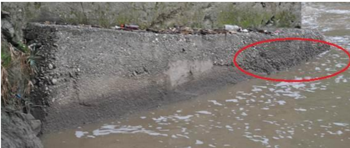
Figura 71. Socavación local en la aleta del estribo (costado Occidental). Fuente (Autores).Enero 2013
