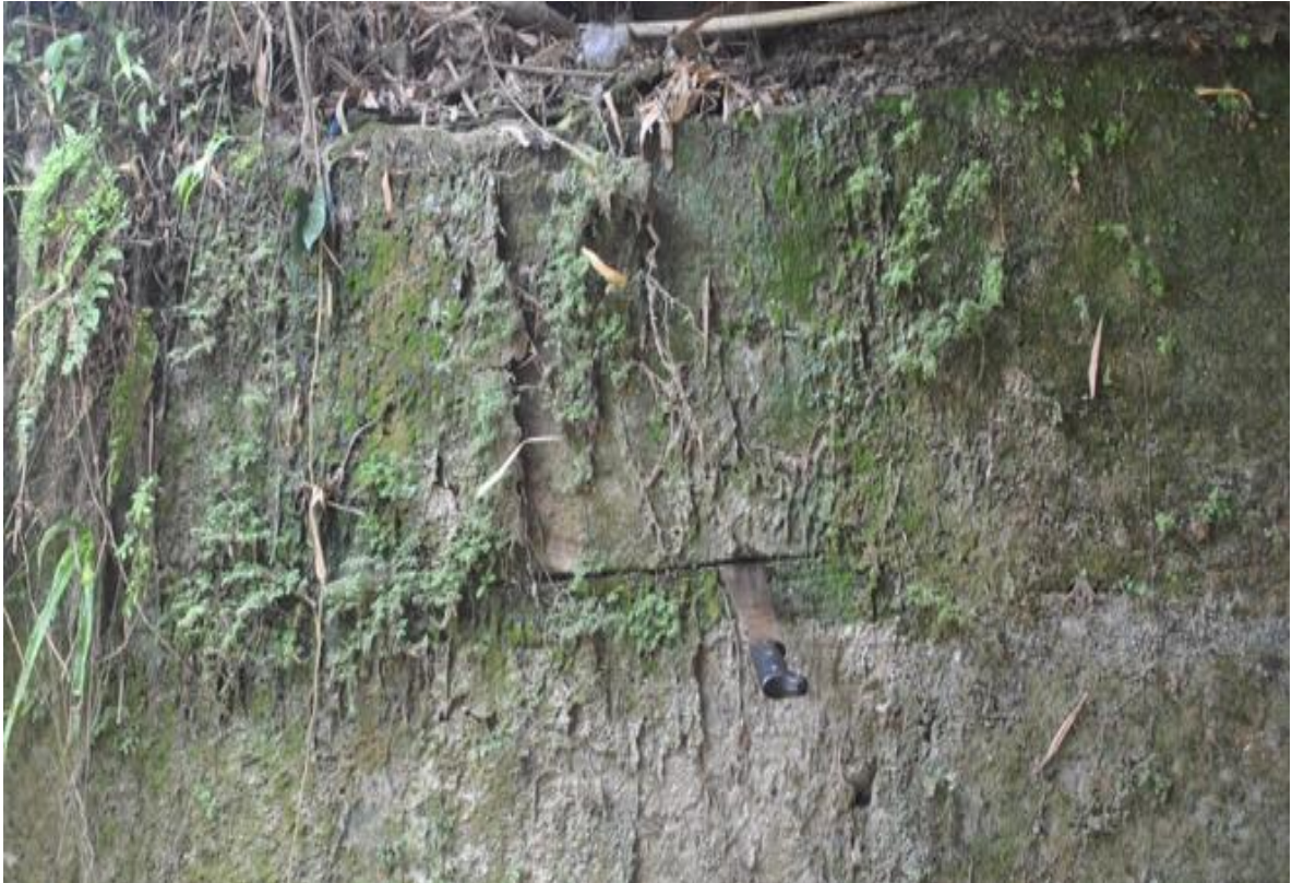
Figura 16. Invasión y grieta de gran espesor y profundidad en la pantalla del estribo costado oriental. Fuente (Autores).Enero 2013
