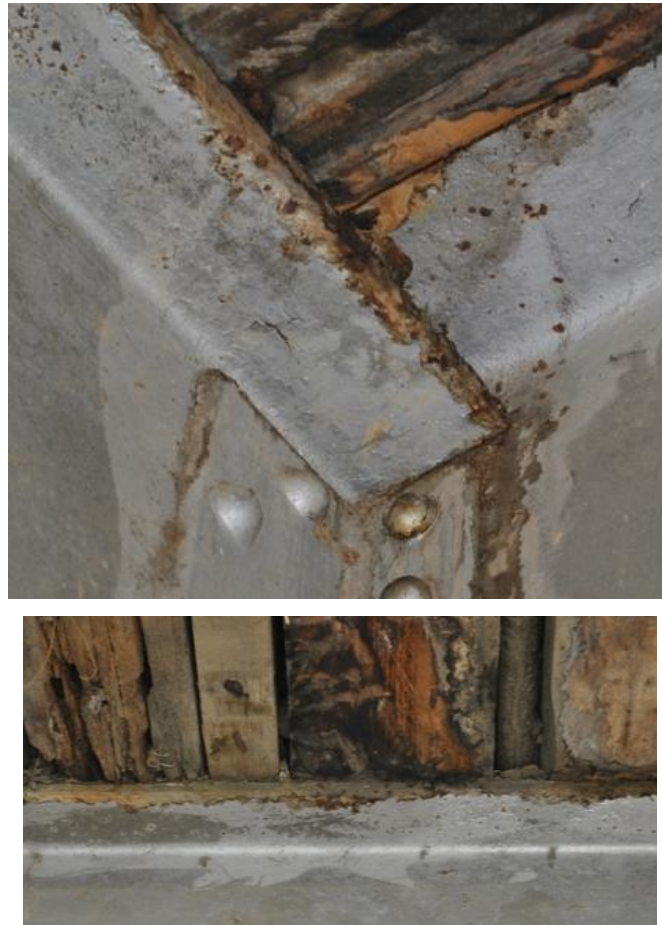
Figura 27. Estado de corrosión media de elementos. Fuente (Autores).Enero 2013
