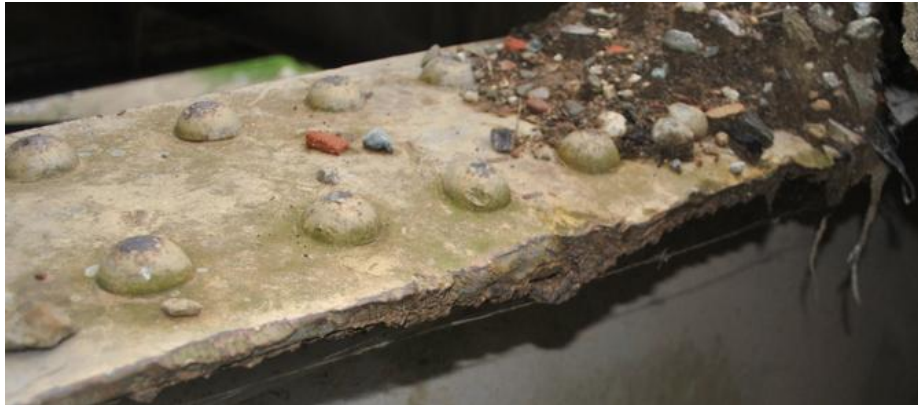
Figura 83. Corrosión media viga puente 2. Fuente (Autores).Enero 2013
