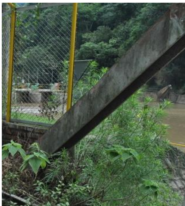
Figura 29. Elemento con pintura deteriorada. Fuente (Autores).Enero 2013
