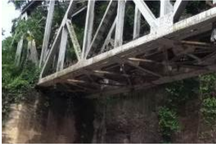
Figura 60. Contaminación estribo occidental puente 2. Fuente (Autores).Enero 2013
