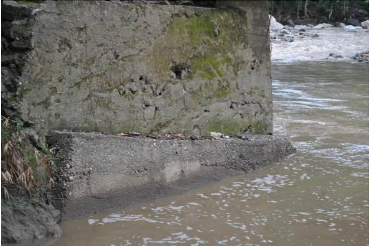
Figura 57. Daño en la aleta del estribo (costado Occidental). Fuente (Autores).Enero 2013
