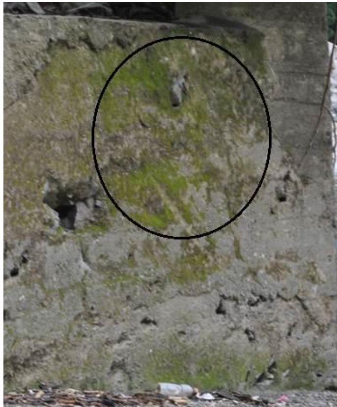
Figura 61. Invasión por parte de microorganismos vegetales y hormigueros en el estribo occidental del puente 2. Fuente (Autores).Enero 2013
