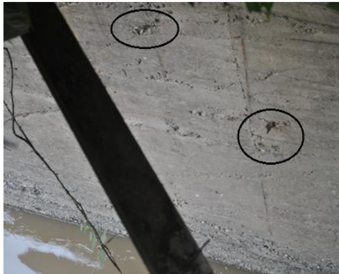
Figura 55. Hormigueros en la parte superior. Fuente (Autores).Enero 2013
