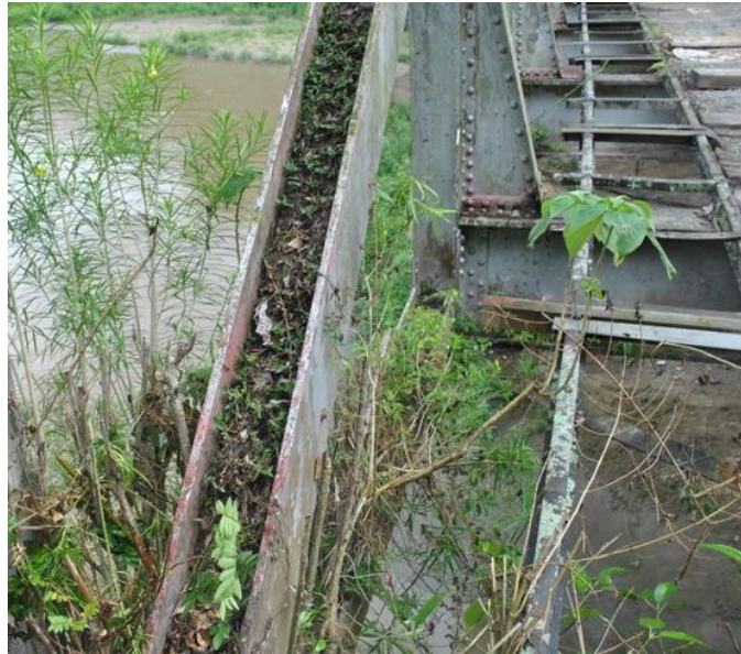
Figura 12. Acumulación material orgánico en elementos. Fuente (Autores).Enero 2013
