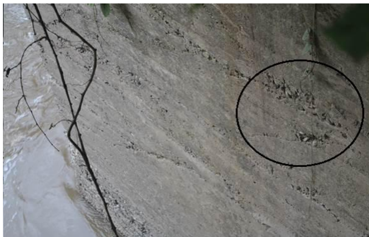
Figura 56. Hormigueros en la parte superior. Fuente (Autores).Enero 2013
