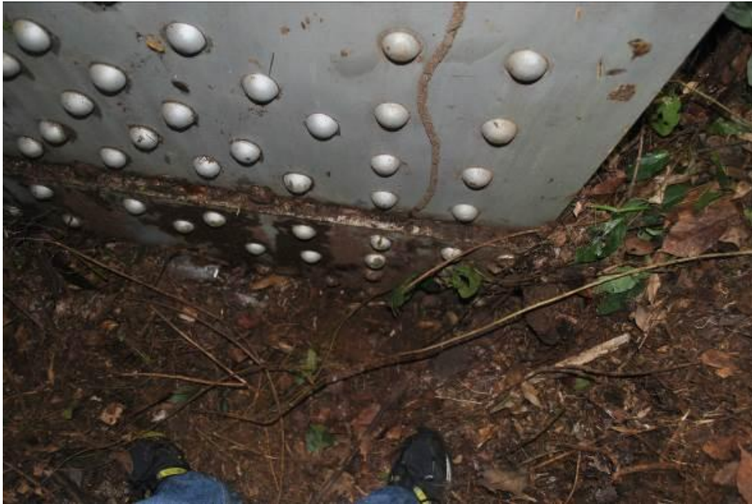
Figura 49. Estado apoyo puente 2. Fuente (Autores).Enero 2013
