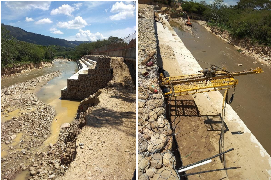
Fotografías 49 y 50. Residuos de material de río en el muro de gavión y perforación de los anclajes. Fuente: Propia.
