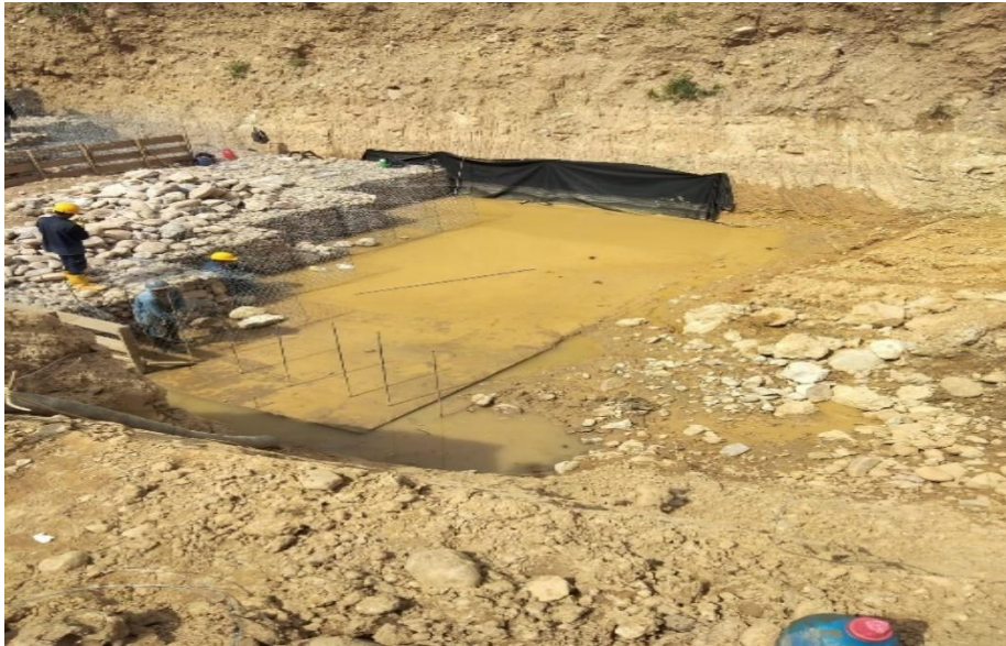
Fotografía 18. Geotextil Tipo Nt-2500 No Tejido O Similar y fundición del solado en la base de los gaviones con agregado grueso de grano anguloso. Fuente: Propia.
