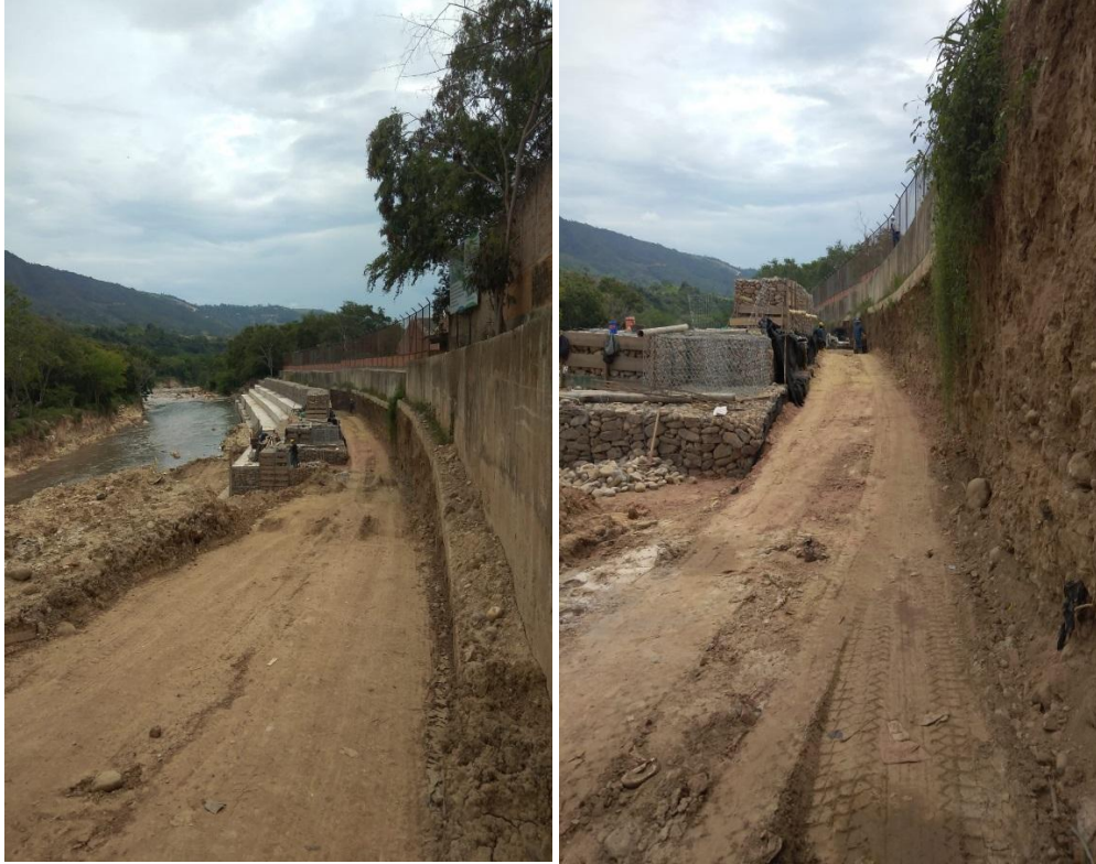
Fotografías 37 y 38. Pérdida del Jarillón. Fuente: Propia.
