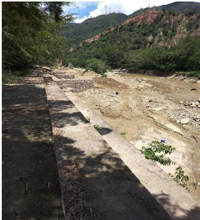
Fotografía 51. Avance en la conformación de Jarillón, espigones y de fundida para el dentellón en este sector. Fuente: Propia.
