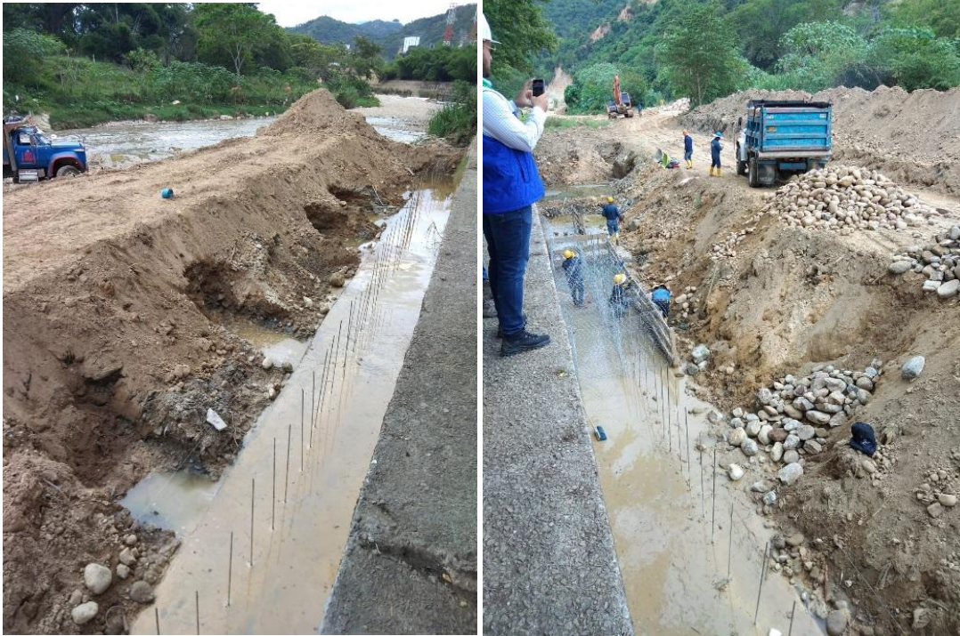
Fotografías 44 y 45. Conformación del dentellón en el cuarto frente de obra. Fuente: Propia.
