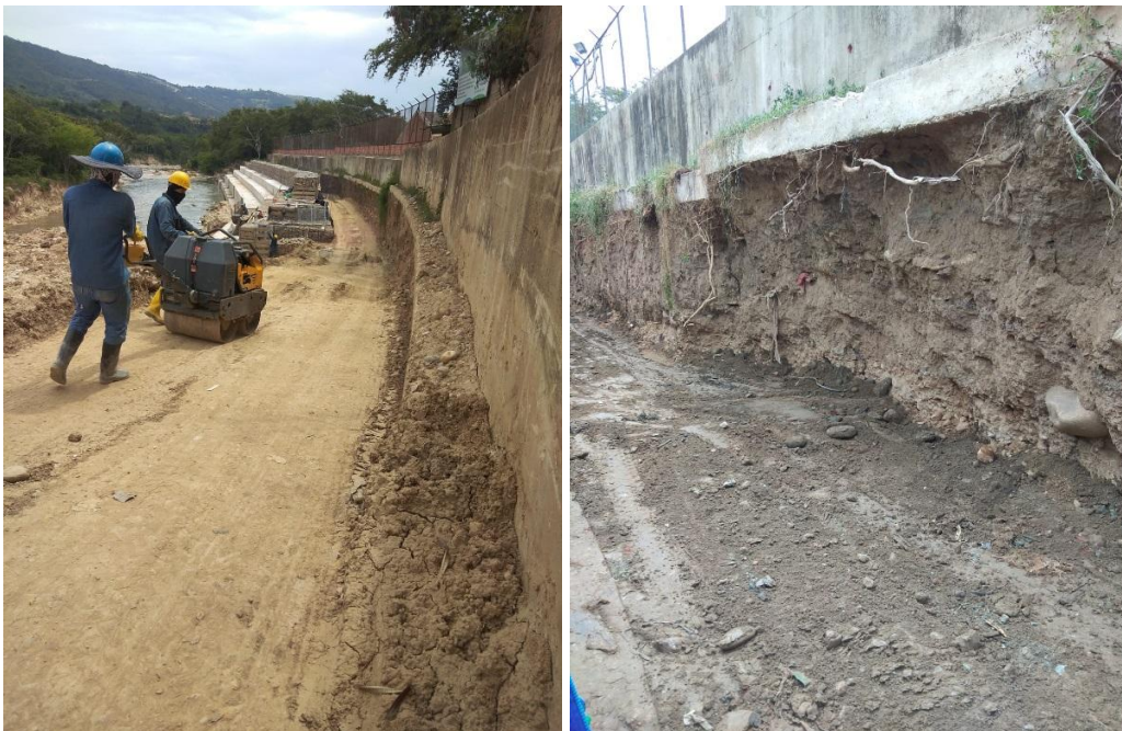
Fotografías 39 y 40. Erosión en la base del muro de cerramiento. Fuente: Propia.
