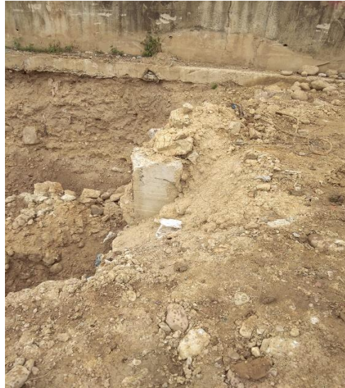
Fotografía 33. Colapso del dentellón anterior. Fuente: Propia.
