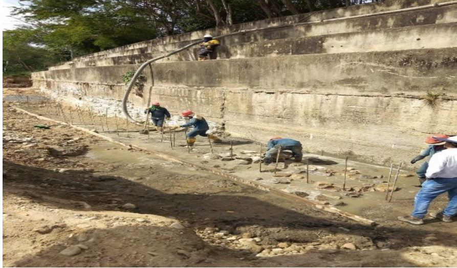
Fotografía 15. Suministro y colocación de concreto ciclópeo y del acero de refuerzo para el dentellón. Fuente: Propia.
