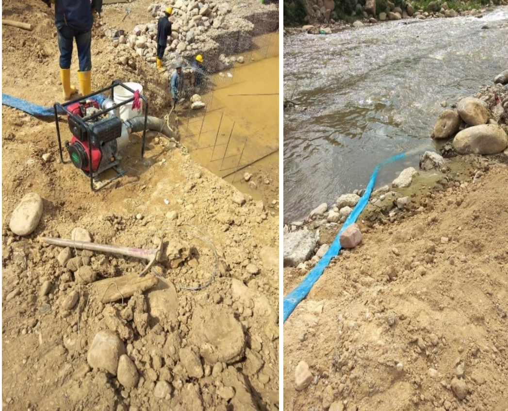
Fotografía 19 y 20. Extracción del agua infiltrada. Fuente: Propia.
