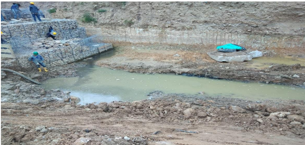
Fotografía 32. Problemas por filtración de agua. Fuente: Propia.
