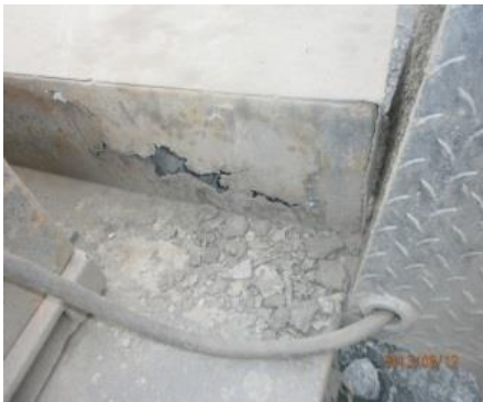
Figura 35. Corrosión en Guardabarros Guardabarros.
