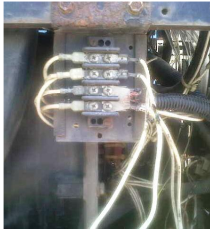
Figura 24. Líneas de estator quemadas
