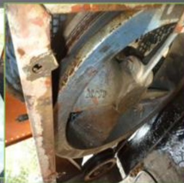
Se zafó correa del Ventilador del compresor.
