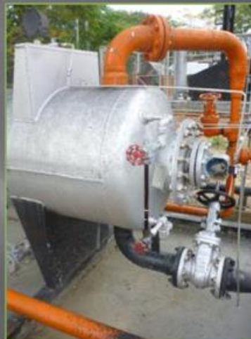
Se observa visor del separador contaminado totalmente.
