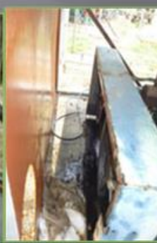
Se evidencia fuga de aceite de lubricación por fuera del compresor.
