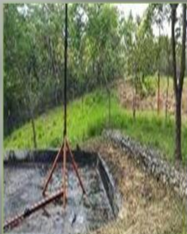
Se observa contaminación línea de gas y del dique impermeabilizado de la tea.
