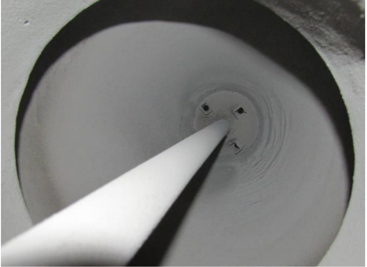
Foto 19. Suciedad en aislador soporte precipitador unidad 3
