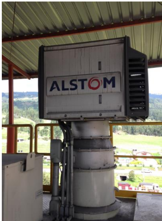
Foto 5. Unidad SIR instalada en el campo 1 del precipitador de la unidad 3.
