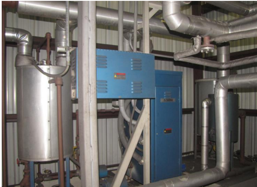
Foto 7. Generador de vapor del sistema de calentamiento tanque derretidor de azufre.
