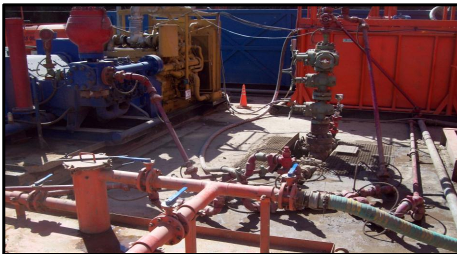
Figura 12. Cabezal de pozo en operación onshore.
