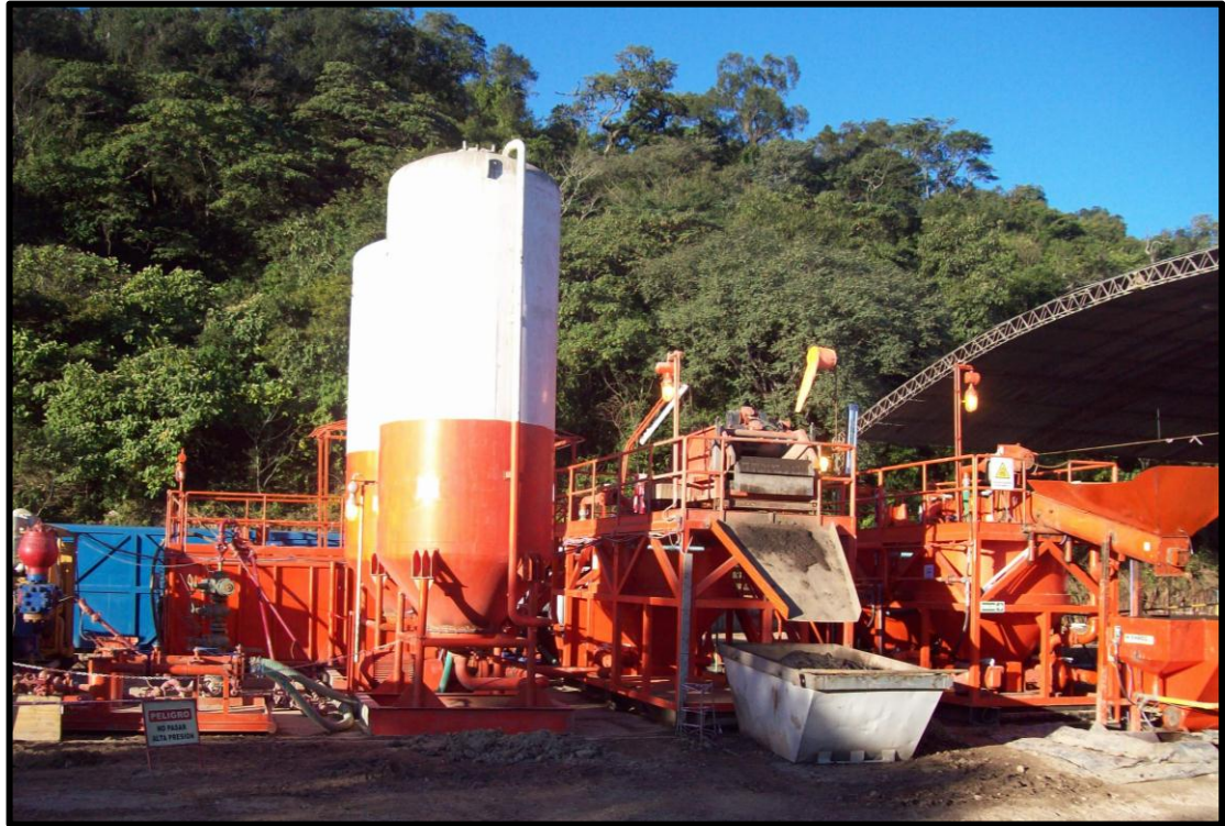
Figura 19. Tanque de almacenamiento.
