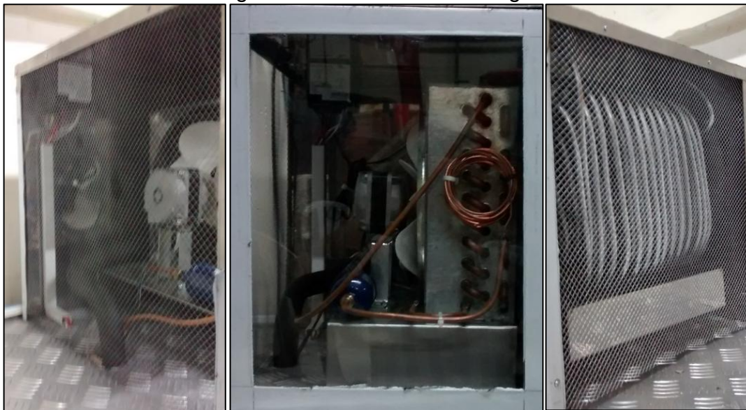
Figura 83. Estado final del generador atmosférico de agua.
