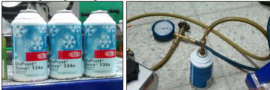
Figura 81. Carga del gas refrigerante.
