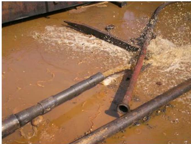
Figura 2. Auto Flow Valve con Bomba funcionando
