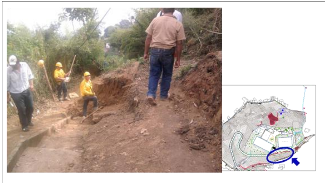
Figura 3. Deslizamiento costado sur, junto a la potería de acceso a la zona de floculación y coagulación (Fotografía tomada en junio de 2011)
