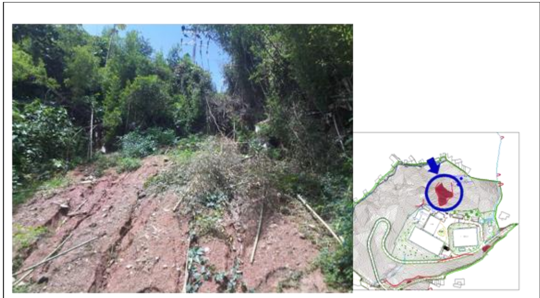
Figura 5. Proceso erosivo sobre el costado norte de la planta, talud inferior del sector de la planta de energía. (Fotografía tomada en mayo de 2011).
