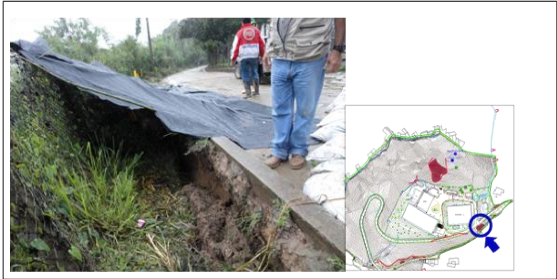
Figura 2. Deslizamiento costado sur, junto a la potería de acceso principal a la Planta (Fotografía tomada en el año 2010)
