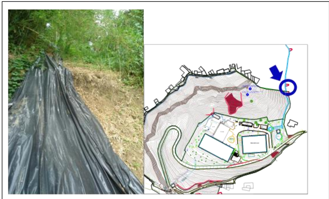
Figura 7. Deslizamiento que afecto el talud superior de la conducción. (Fotografía tomada en Junio de 2011).
