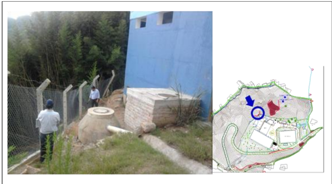
Figura 6. Deslizamiento que afecto el talud inferior costado nor-occidental de la Planta, nuevo edificio de bombas. (Fotografía tomada en mayo de 2011)
